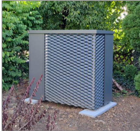
Außeneinheit einer Luft-Wasser-Wärmepumpe
